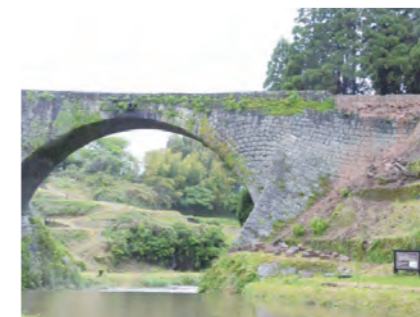
2018年5月に一部崩壊した通潤橋
